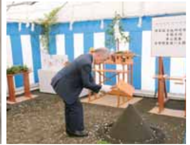
写真 小鹿キャンパス看護学部棟着工における鎮めの儀
